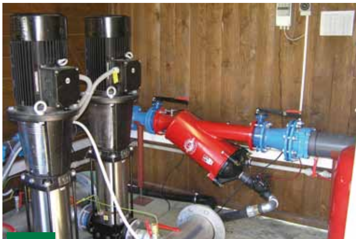
Vícečerpádková čerpací stanice s monitorováním průtoku a filtrem s automatickým proplachem na hřišti v Telči
